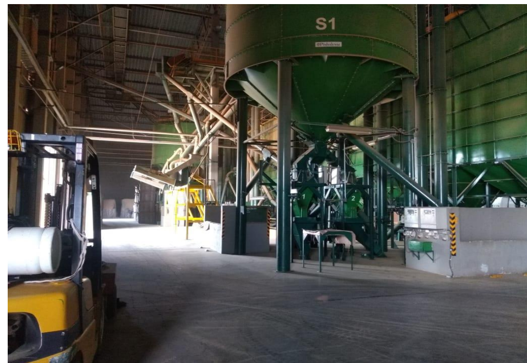
Preparo e Armazenagem de Café
