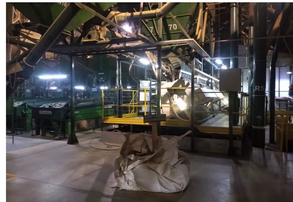
Preparo e Armazenagem de Café
